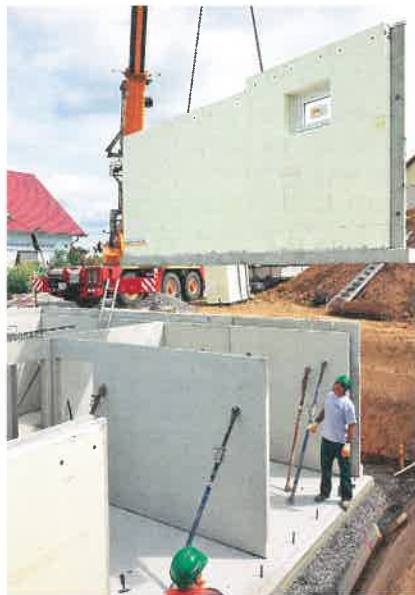
Bei einem Fertiggeller werden die Wände – inklusive Fenster und Dämmung – im Werk vorgefertigt, kommen per LKW auf die Baustelle und werden dort mithilfe eines speziellen Krans an ihren Bestimmungsort gesetzt. Das ermöglicht eine sehr kurze Bauzeit, hohe Termin- und Kostensicherheit sowie eine optimale Qualitätskontrolle. www.knecht.de
